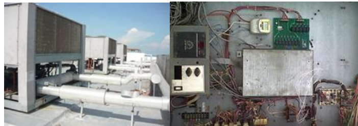
Figura 1. Sistema de acondicionamiento de aire tipo chiller Fuente: Elaboración propia (2013)
